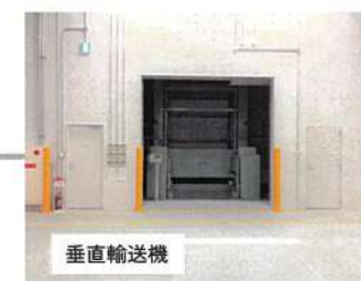
貨物用エレベーター
